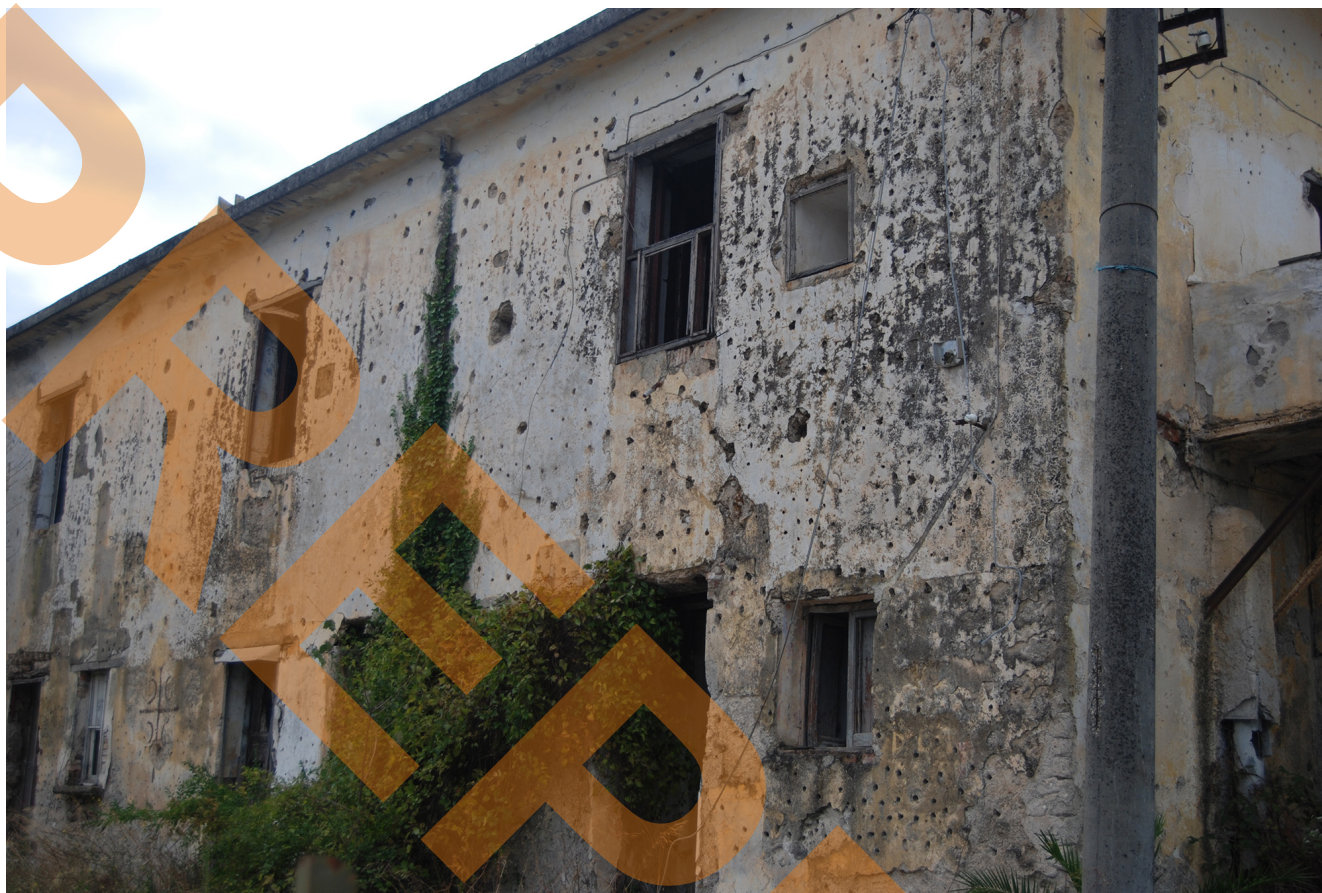
6: M. Villani, Uno degli edifici adiacenti la reggia di Persano con i segni dei proiettili ancora visibili sui prospetti.
