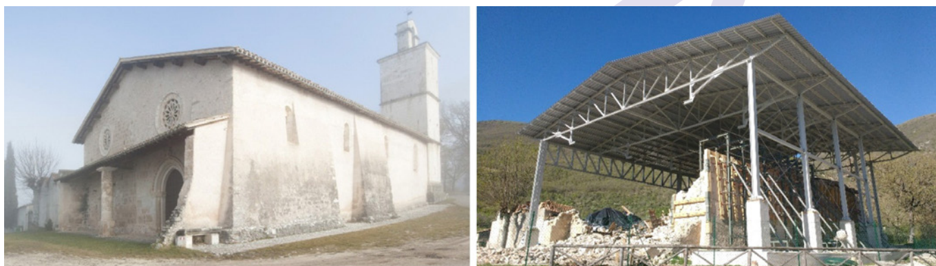
Fig. 6. Campi di Norcia. La chiesa di San Salvatore prima e dopo gli eventi sismici del 2016-2017.
