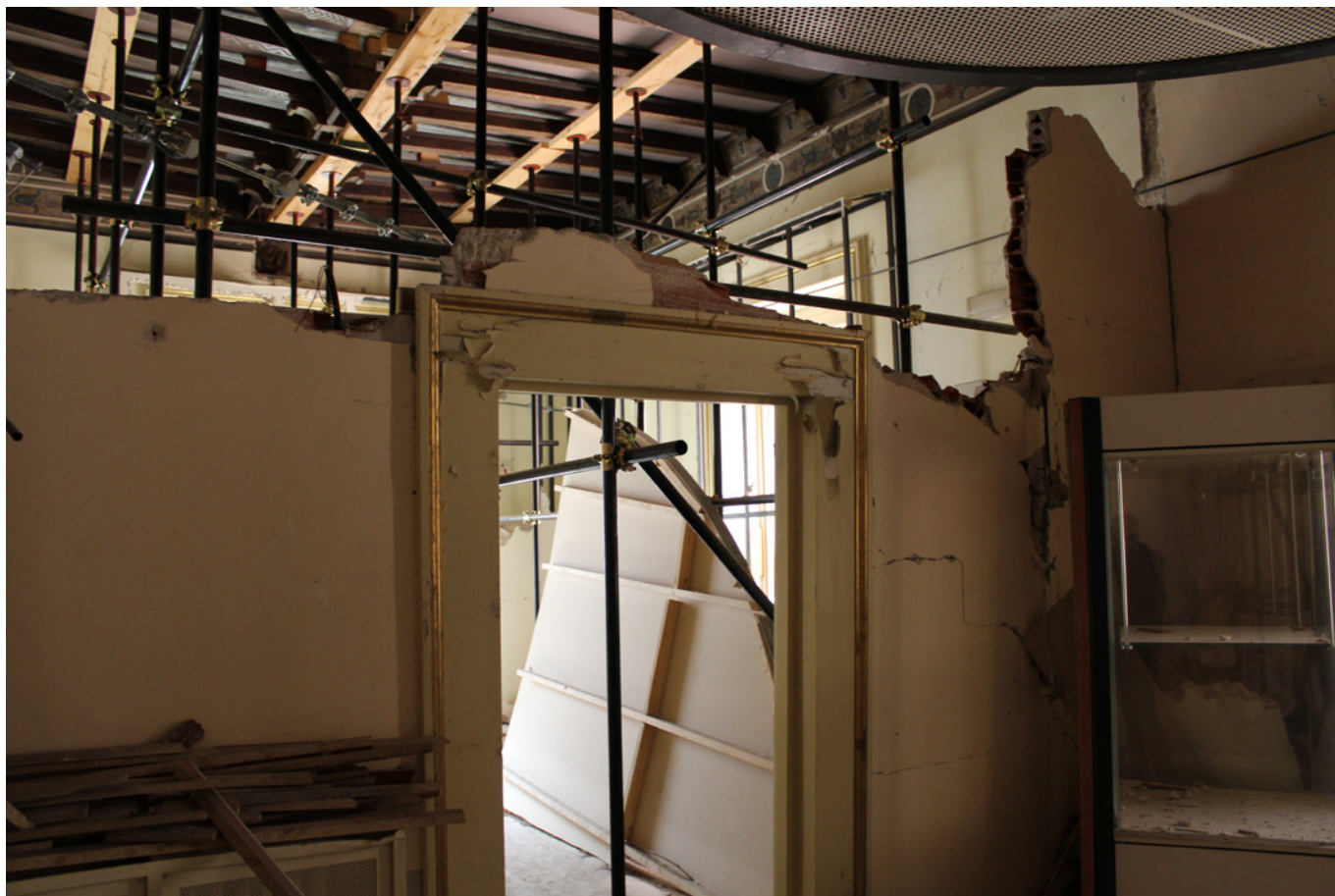
FIG. 4. Stato del danno all'interno del percorso museale.
