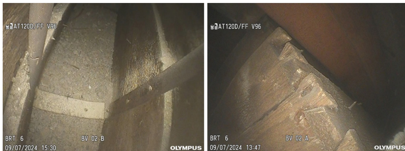
FIG. 4. Le indagini endoscopiche hanno consentito di approfondire il sistema di appensione del soffitto ligneo della Sala della Stufa Valtellinese. In particolare hanno consentito di individuare le cavità all'interno delle travi e controtravi del cassettonato, nonché le regge metalliche messe in opera per ancorare tra loro le tavole lignee che definiscono le nervature tra i lacunari, e le connessioni strutturali tra le teste delle medesime tavole lignee, a coda di rondine. Immagini degli autori.
