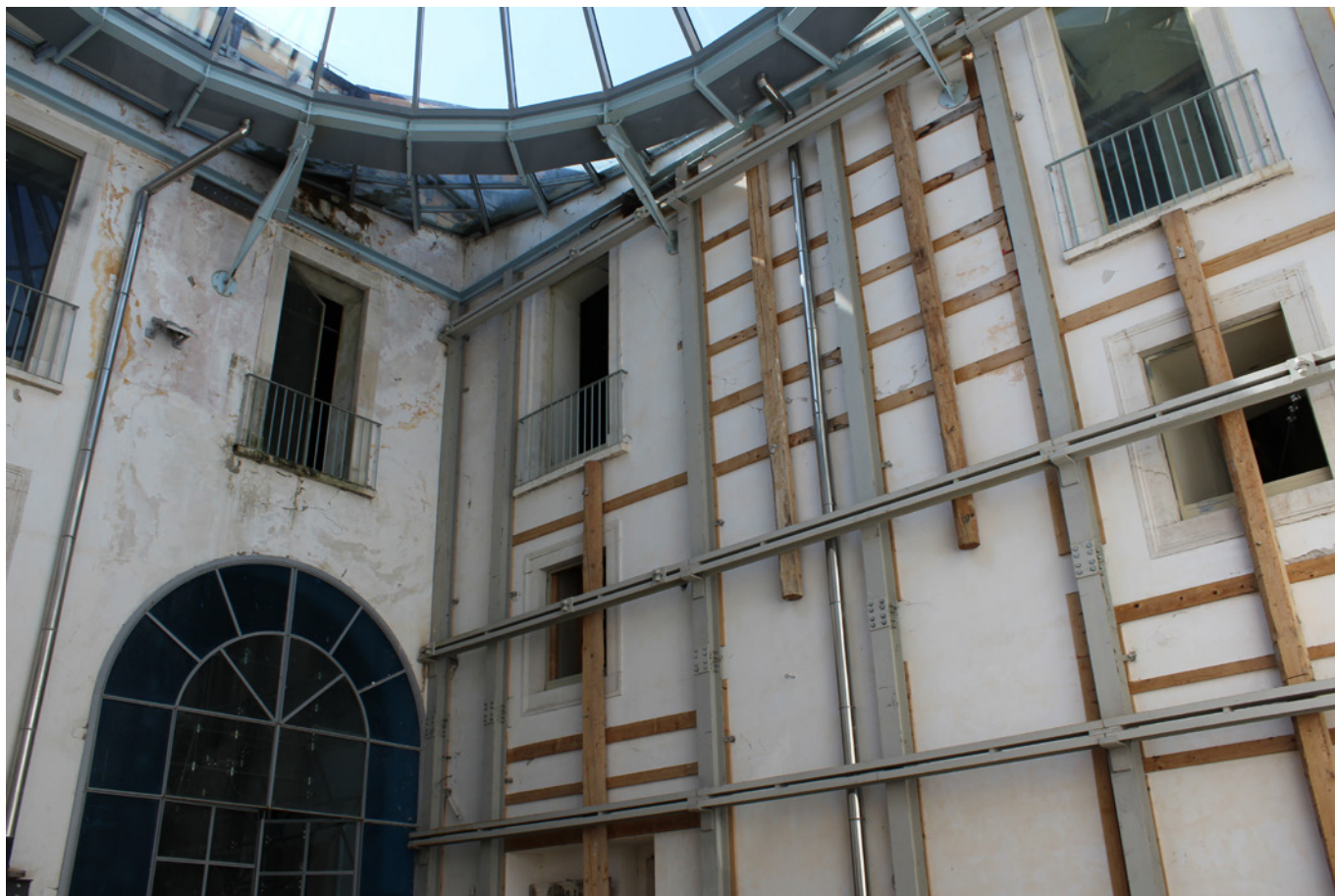
FIG. 3. Cortile con la copertura del progetto Di Marco e stato del danno con i puntellamenti.
