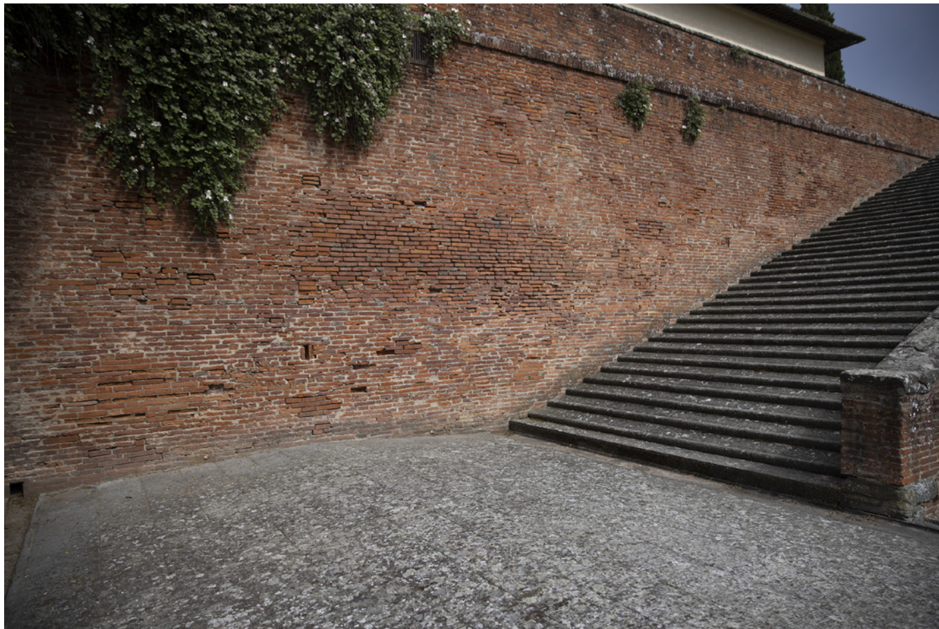
Fig. 4. L'interpiano a schiena d'asino in arenaria della rampa nord mostra come la muratura in laterizio appaia in uno stato di avanzato degrado causato dalla colonizzazione biologica, i cui metaboliti secondari, in particolare gli acidi ossalico e carbonico, determinando una duplice azione degradativa: chimica, attraverso la solubilizzazione dei leganti, e meccanica, per via della penetrazione delle ife nei pori e nelle microfessure preesistenti.
