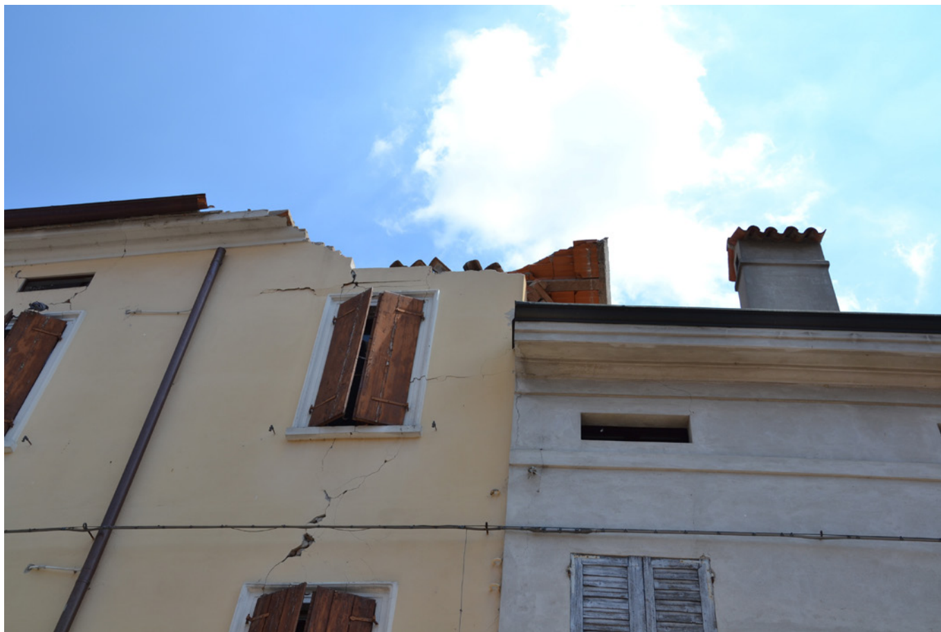
FIG.1 Danneggiamento edifici in cortina caratterizzati da solai sfalsati
