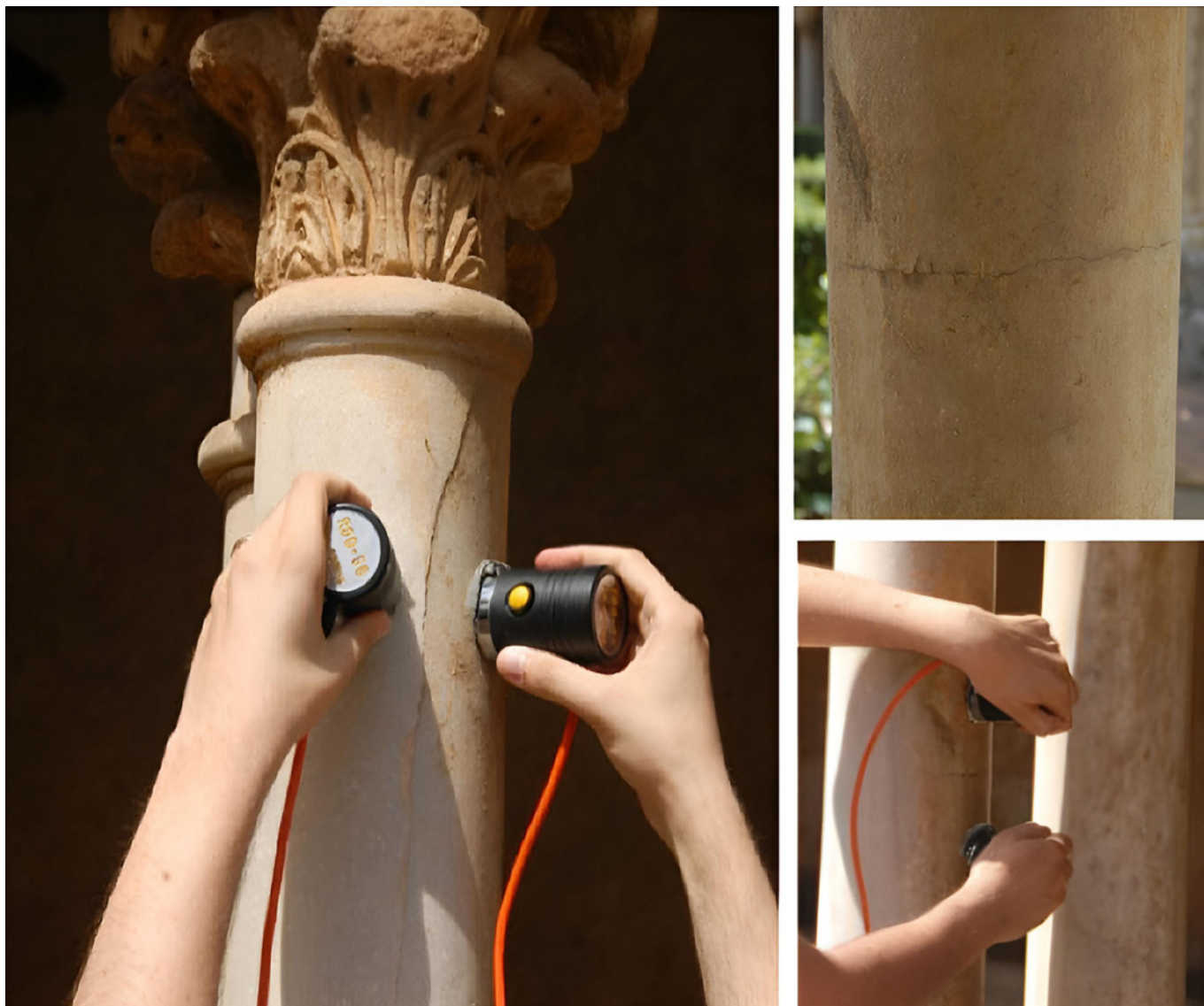
FIG. 5 – Laura Rappa, Prove ultrasoniche sulle colonnine situate a sud del “Capitello della Dedicata”: posizionamento delle sonde in modalità diretta in corrispondenza della lesione verticale e configurazione dei trasduttori a cavallo della frattura orizzontale in modalità indiretta.
